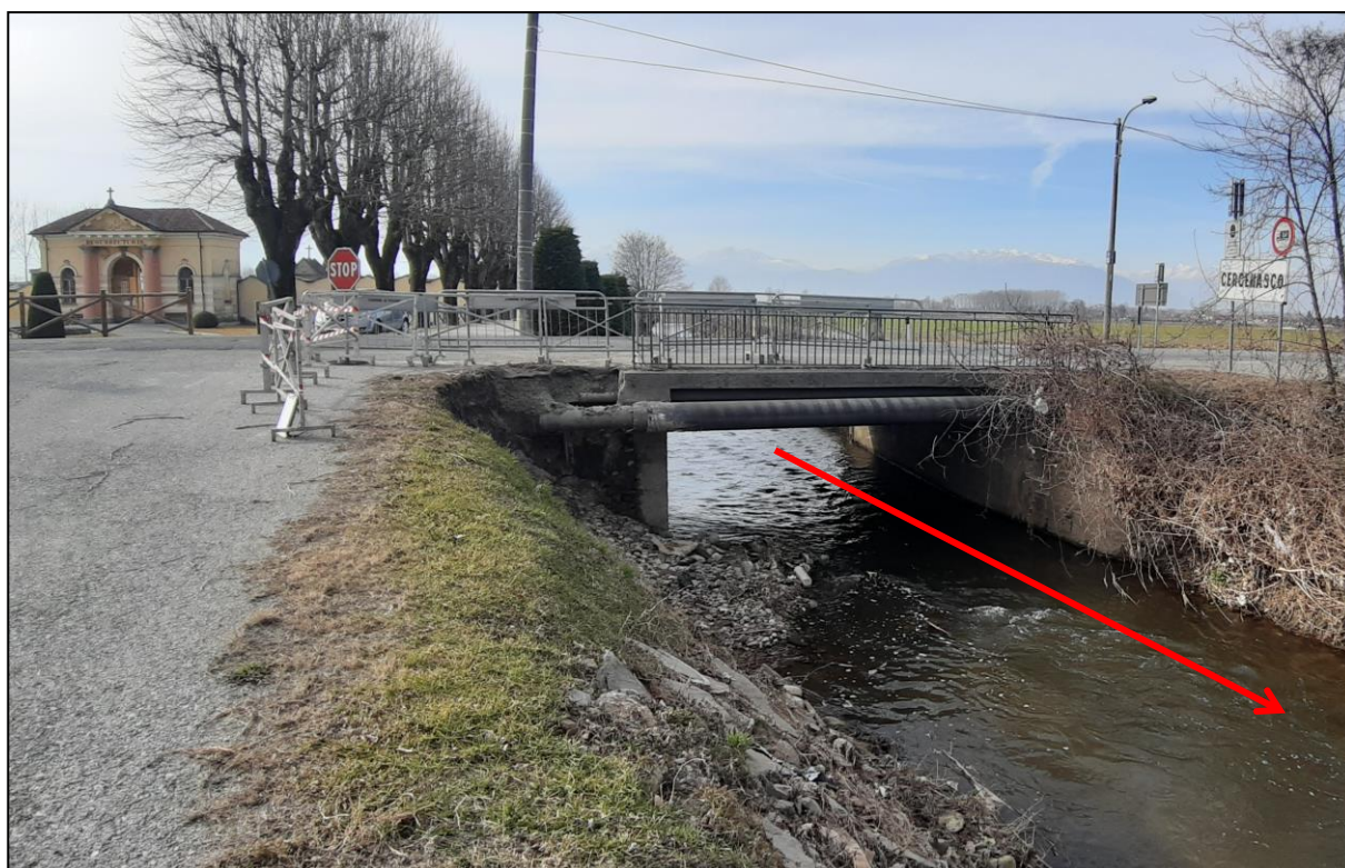
Fig. 1: ponte esistente oggetto di rifacimento, con in evidenza l'erosione di sponda idrografica destra; la freccia indica il verso della corrente. Foto realizzata dallo scrivente, nel mese di maggio 2020.
