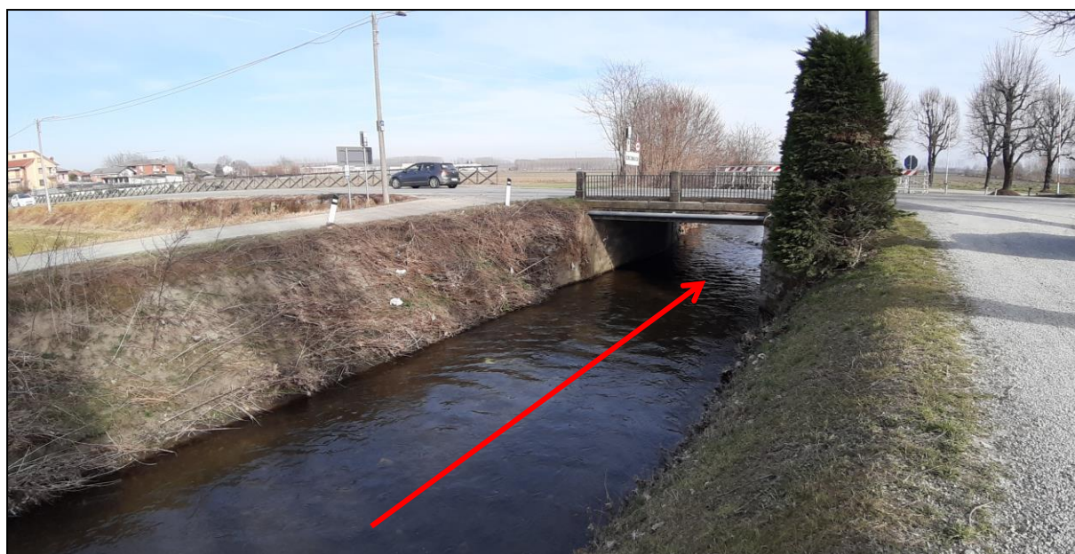
Fig. 3: ponte esistente oggetto di rifacimento; la freccia indica il verso della corrente. Foto realizzata dallo scrivente, nel mese di maggio 2020 in occasione del sopralluogo.
