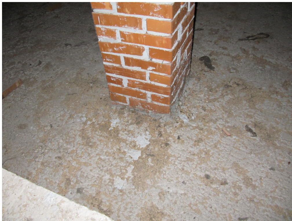
Figura 20 - Particolare pilastro in mattoni in appoggio sul solaio
