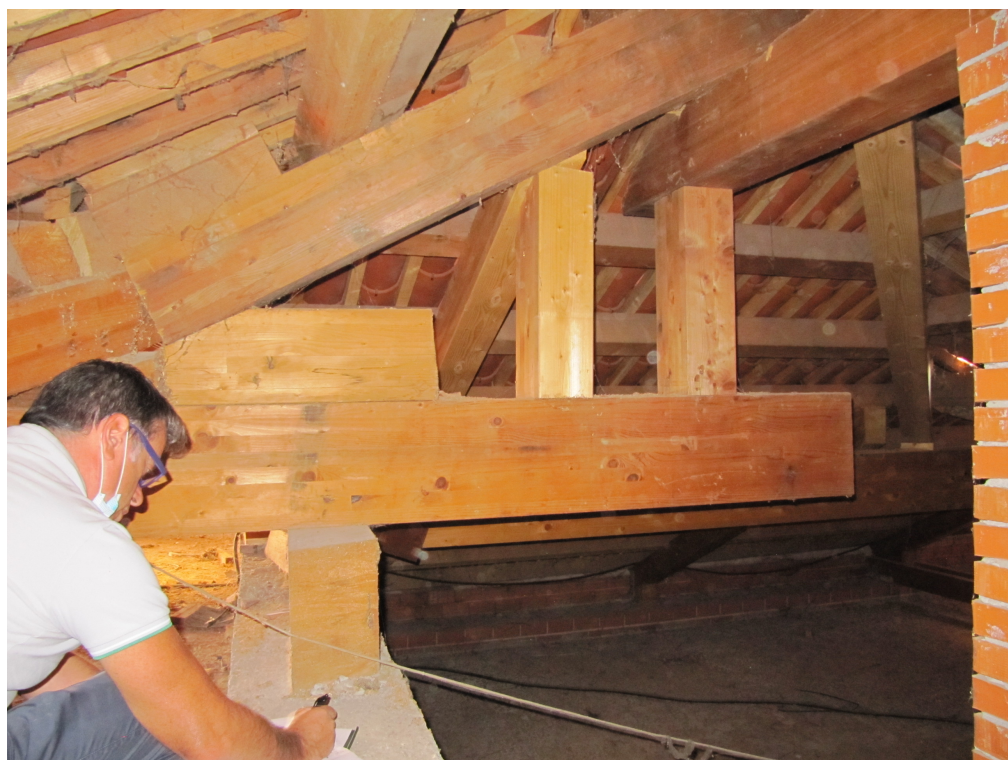
Figura 15 - Particolare appoggio instabile della copertura in legno tra i corpi B e D
