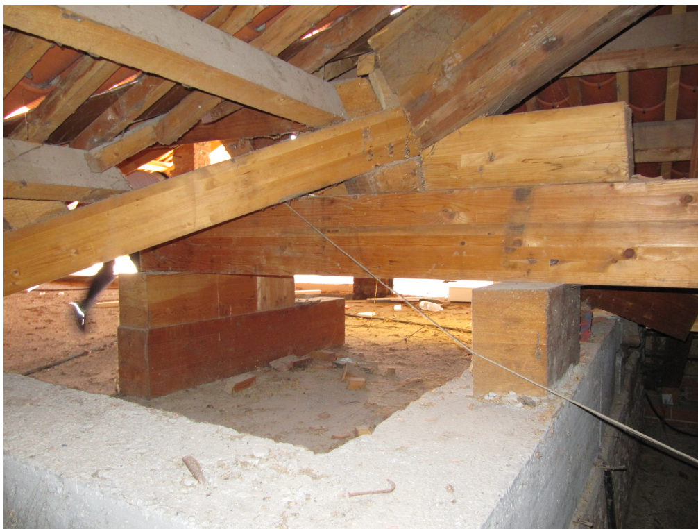
Figura 16 - Particolare appoggio instabile della copertura in legno tra i corpi B e D
