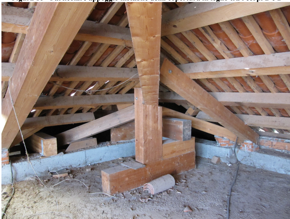
Figura 17 - Particolare appoggio instabile della copertura in legno tra i corpi B e D
