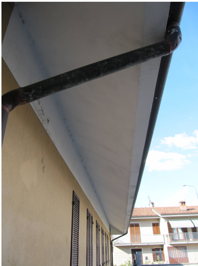
Figura 6 - Particolare tettucci in c.a.
