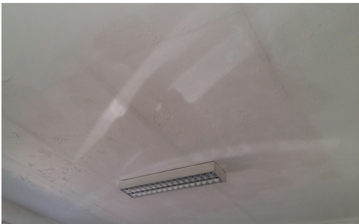
Figura 11 - Particolare infiltrazioni su solaio di copertura dell'aula di musica
